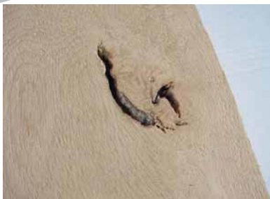
FORO O FESSURA O SPIGOLO DA RIPARARE
