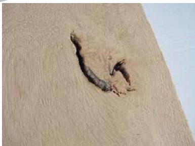
FORO O FESSURA O SPIGOLO DA RIPARARE
